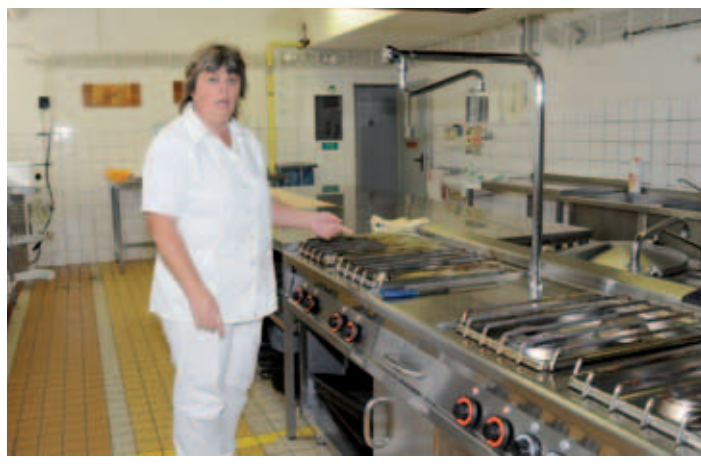
V kuchyních mateřské školy Chelčického a Bachmačská došlo k nákupu a výměně kuchyňského zařízení. Kuchyně byly vybaveny novými konvektomaty, sporáky, nerezovými stoly a dřezy. Celková hodnota díla je 1,5 milionu korun bez DPH.
