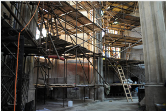
■ V současné době stojí lešení v Řeznické kapli, kde pokračuje rekonstrukce. Po jejím dokončení budou následovat renovace dalších kaplí v jižní části chrámu. Foto: šk
