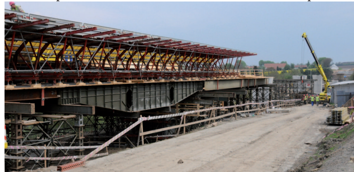
■ Nejnáročnější stavbou obchvatu je most přes Štítarské údolí. Dokončen by měl být v závěru příštího roku. foto: šk
