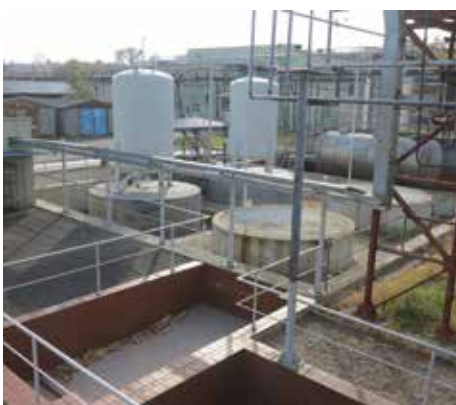
Rampy, potrubní lávky, tlakové nádoby... prostředí typické pro každou chemickou výrobu
