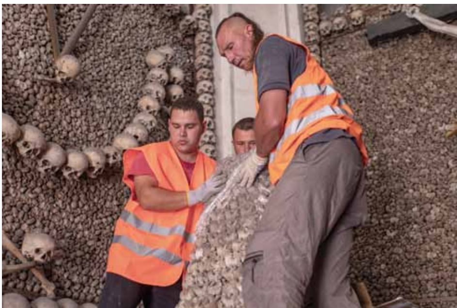
V červnu začala nejnáročnější fáze revitalizace chrámu sv. Bartoloměje - restaurátorské práce v kostnici. Do restaurátorské dílny byly převezeny pyramidy z kostí, které zde budou vyčištěny a znovu sestaveny. Rekonstrukcí projde i barokní stavba samotné kostnice, v níž se plánuje oprava podlahy, fragmentů na stěnách a výměna elektronistalace. Restaurátorské práce v kostnici potrvají dva roky. Foto: Roman Šulc
