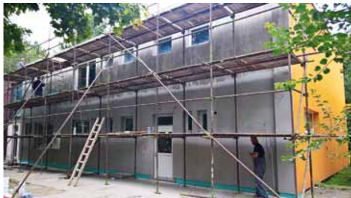
Stavební práce na budově pro dětskou interiérovou hernu v ulici Rimavské Soboty. Foto: Tomáš Růžička
