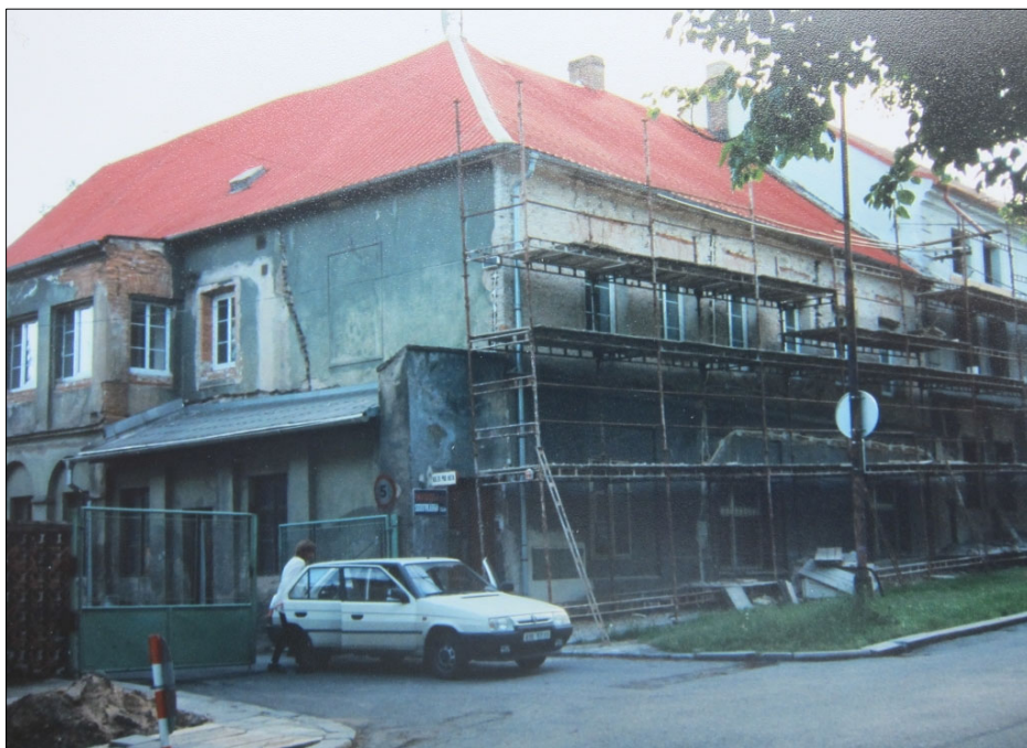
Fotografie z rekonstrukce objektu z počátku 90. let minulého století. Budova má již novou střechu
