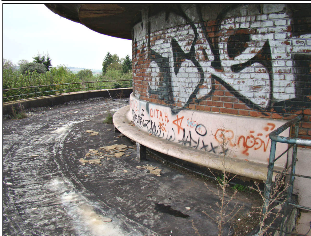
Fotografie současného stavu spodní části a ochozu vodárenské věže neboli věžového vodojemu
