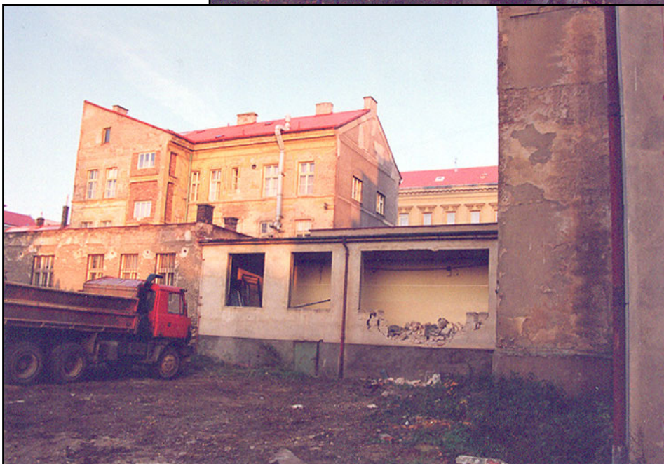
Práce na rekonstrukci obou budov, tedy historicky na sirotčinci a prvorepublikové nemocenské pokladně. Práce probíhaly v letech 1995 až 1996
