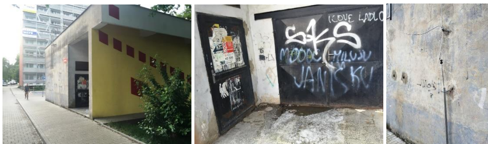
Výměňíková stanice – poškozený hromosvod, posprejované a polepené plochy.
