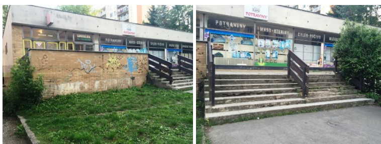
Špatný stav schodů a zdi samoobsluhy.
