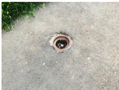
Chybějící víčko kanálku v ulici Radimského.
